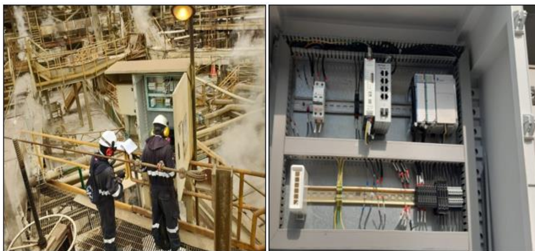
Figura 23. Instalación del Switch de comunicaciones del sistema SCADA en el tablero de PLC.
